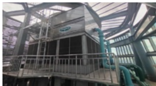
越秀房托对广州四季酒店冷却塔进行改造，改造后空调用电量对比 2019 年减少 21.5%，空调用水量对比 2019 年减少 23%
